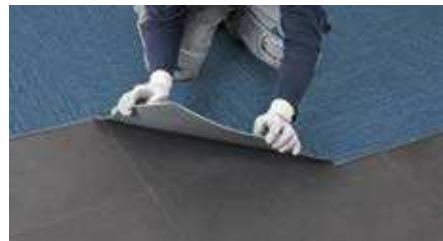
MISE EN PLACE DES LAMES ET DALLES EN POSE LIBRE SI < 30 M 2
